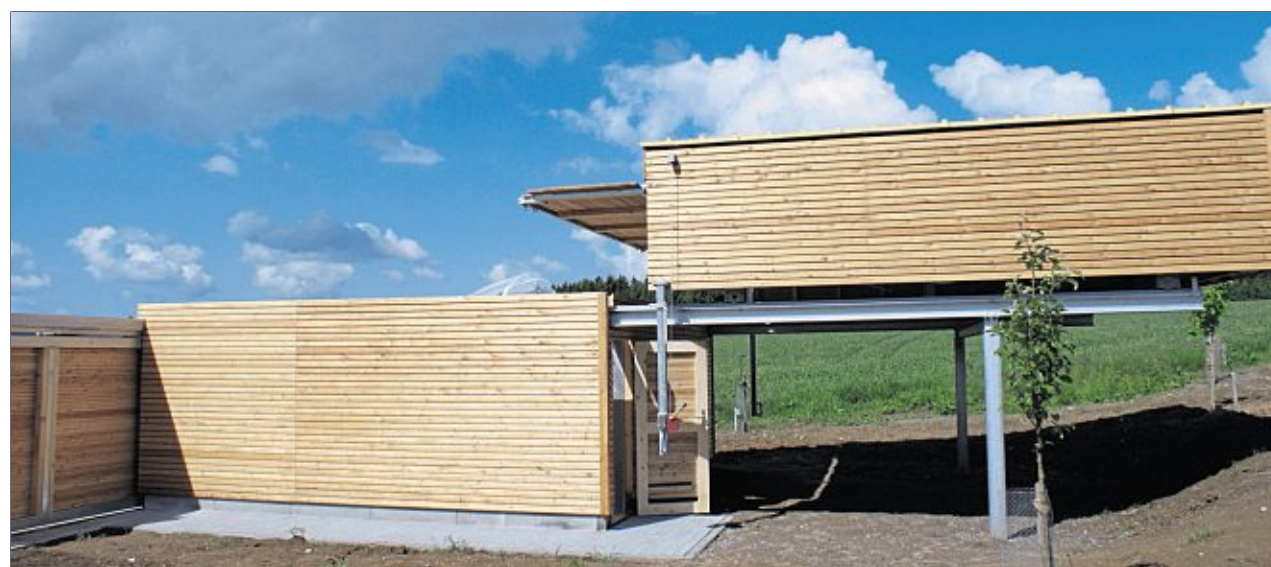
Decke und Wand der Sternwarte sind auf Stahlträgern gelagert und können verschoben werden. Dadurch steht das Teleskop unter freiem Himmel. Sternwarte und Planetarium befinden sich kurz vor der Fertigstellung. Am 26. Juli findet die Einweihung statt. Bilder: weu (2)
